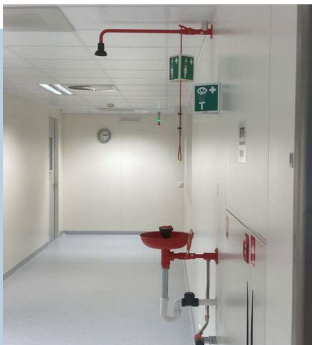
Imagen 13-4: Una ducha y un lavaojos en la farmacia de un hospital (para fines de emergencia en caso de incidente) en el Centro Médico Meander (Países Bajos)
